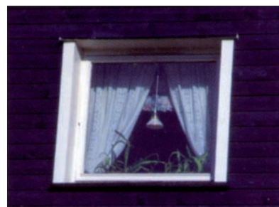
Ved etterisolering bør vinduene flyttes ut i veggen, og ikke som her forsvinne inn i veggen. Foto: Randi Sjølie
