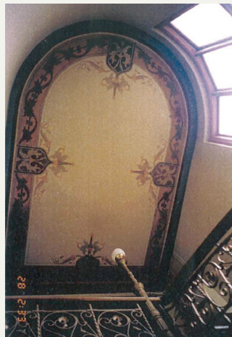
Himlingen skal i slike tilfeller bevares. Adkomst til loftet må sikres på annen måte enn ved gjennombryting av trapperomshimlingen, for eksempel direkte fra leilighet.
